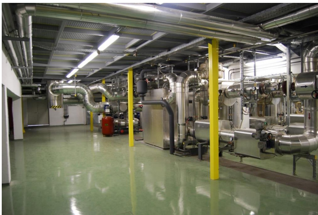
Slika 23: Centralna energetska postaja CEP v objektu Koroška 3a (2008)
